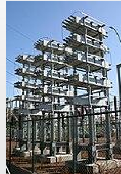
75MVAR 150 kV elektrodistri butivni sistem
